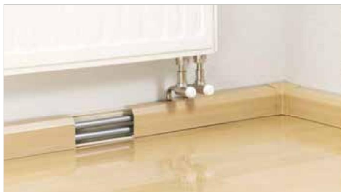
Рис. 16-44 Установленный плинтусный канал RAUSOLO с присоединительными трубками SL-RAUTITAN
